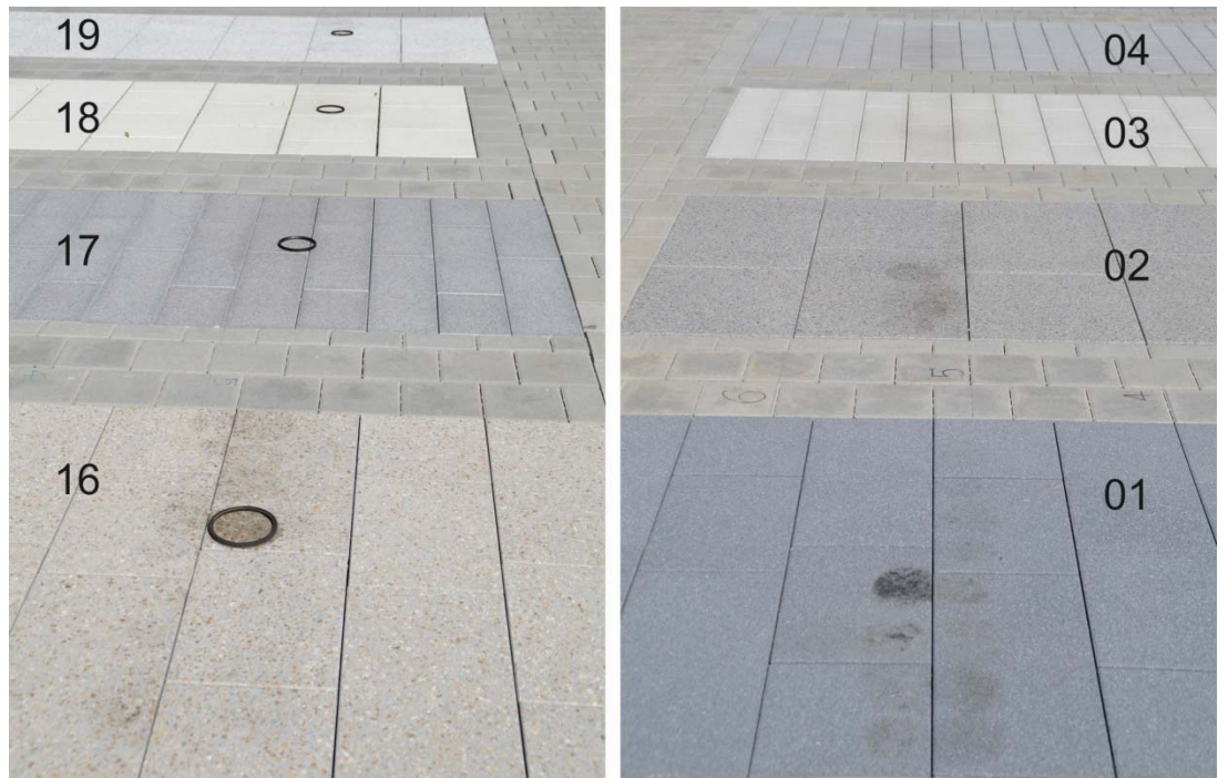
Bild 3.17: Ölflecken auf den beschichteten Steinflächen.
