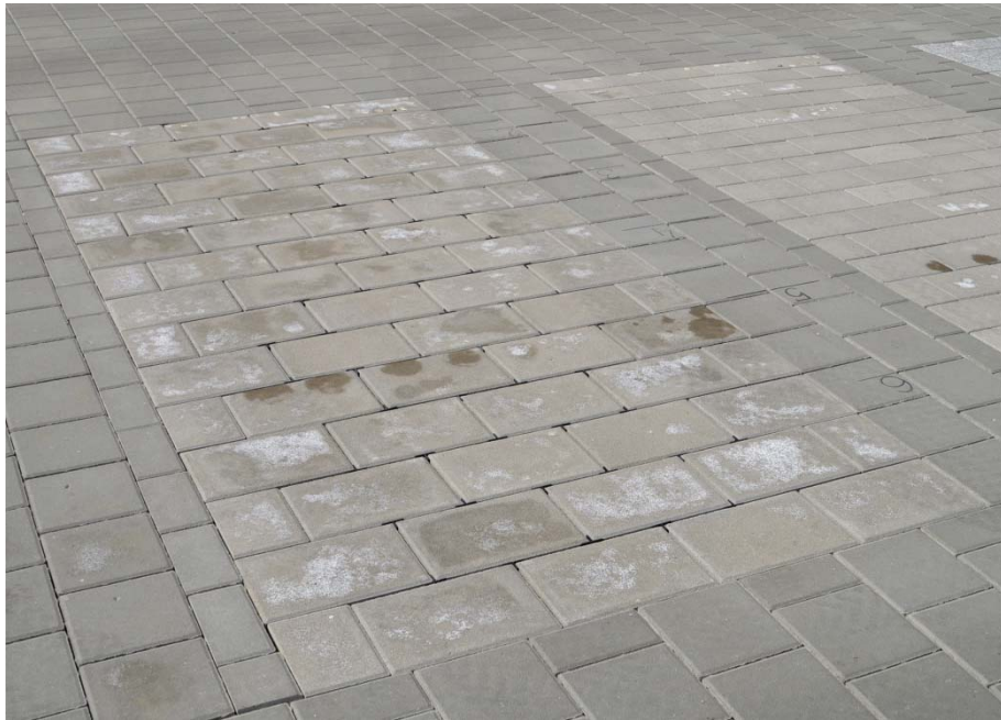
Bild 3.16: Massive weißliche Kalkausblühungen auf Steinen mit betonglatter Oberfläche.
