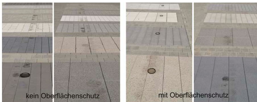
Bild 12. Vergleich von Ölflecken auf Flächen ohne (links) und mit (rechts) Oberflächenschutz. Fig. 12. Comparison of oil stains on surfaces without (left) and with (right) surface protection.
